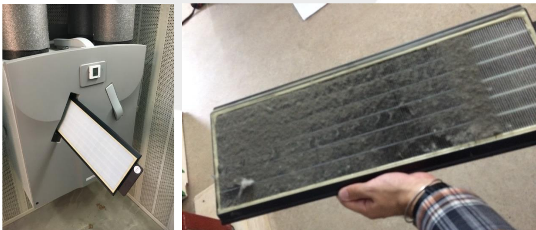
Fuente: Zehnder. Estado de los filtros después de unos meses de uso
