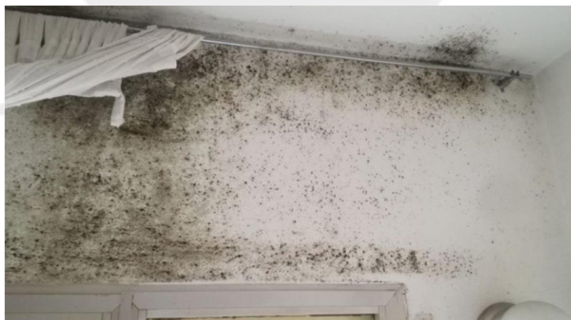
Humedades de condensación
